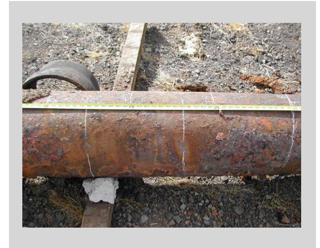
Sistemas de Tuberías Sin Recubrimiento en Operación
